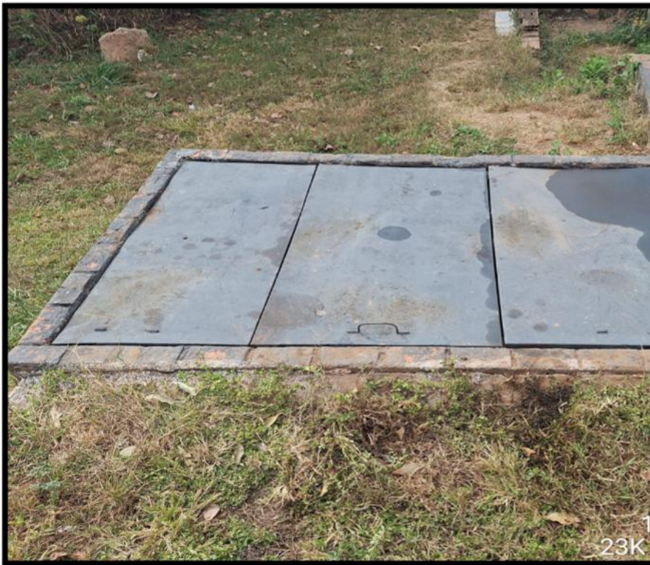
05 - Caixa separadora de água e óleo (CSAO)
