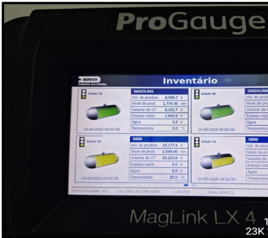
08 – Monitoramento intersticial e medidor eletrônico dos tanques
